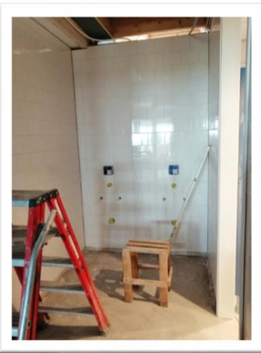
De heren wc betegeld met dezelfde tegel als dames- en MiVa-toilet...
