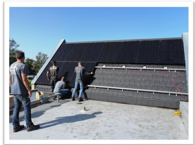
14 panelen op het dak van de dagopvang
