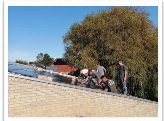
40 panelen op het dak van de grote zaal / peuteropvang
